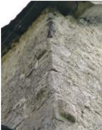
Les pierres à bossage dans les chaînons d'angle de l'ancienne Tour du Bleynet
